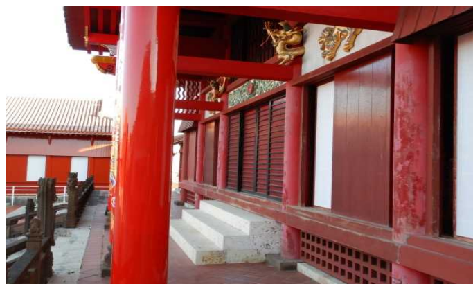
【向拝内側柱、敷居 漆劣化】
