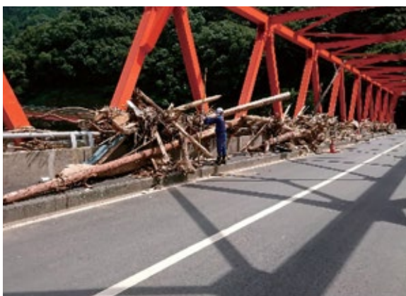
被災状況 (熊本県八代市坂本地区_中谷橋)
