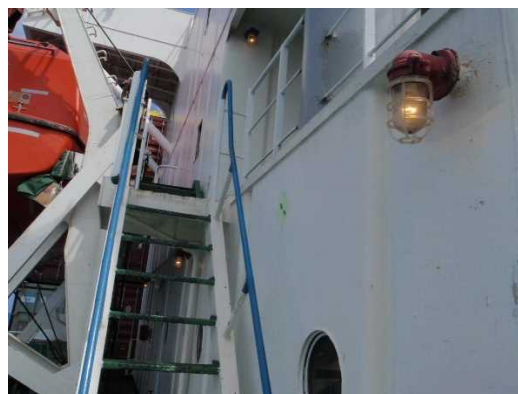
非常照明の点灯を確認
